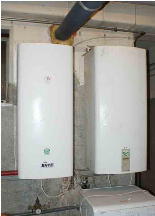
Abbildung 14: 2 Elektro-Boiler im Heizraum mit jeweils 150 Liter Fassungsvermögen
