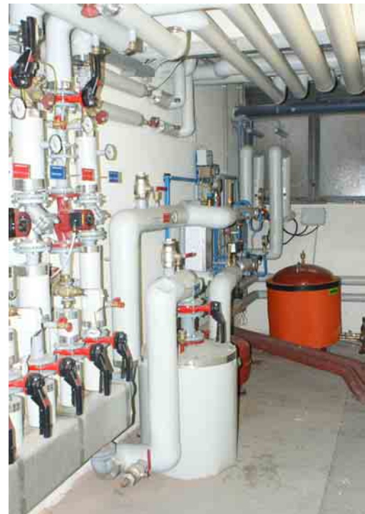
Abbildung 13: Fernwärme-Übergabestation im Heizraum
